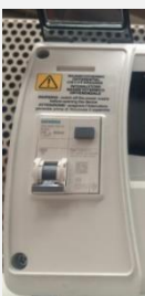
Photo 1 - Disjoncteur différentiel pour la protection et la déconnexion de l'unité de réfrigération
